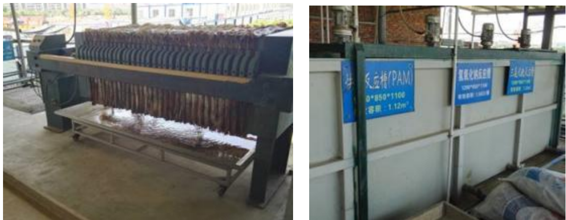
图 4-2 生活污水处理设施图
