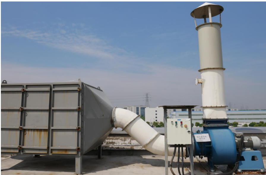
图 4-3 活性炭吸附装置及 P3 排气筒
