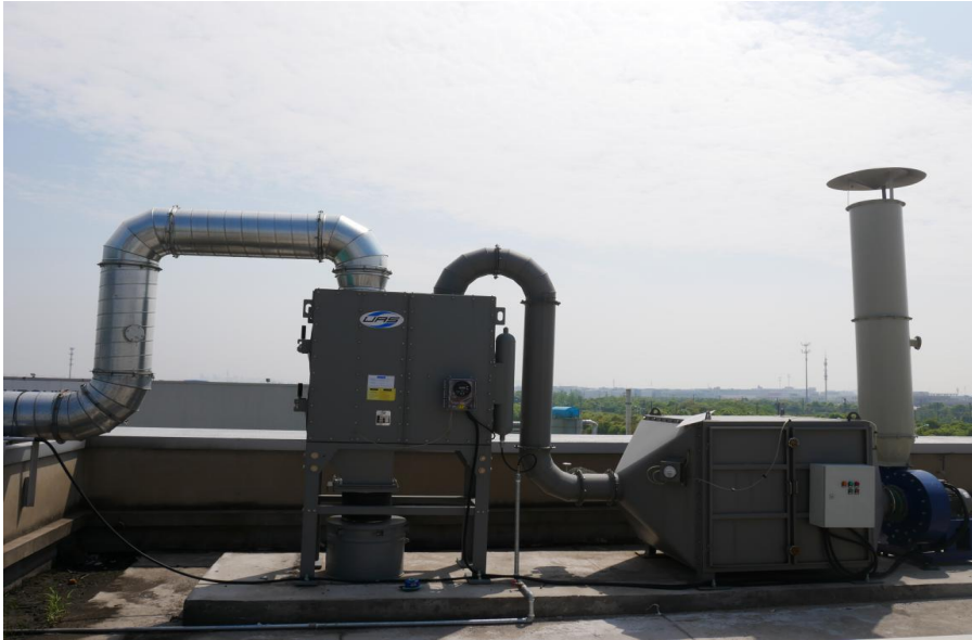
图 4-2 活性炭吸附装置及 P2 排气筒
