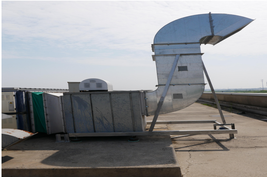
图 4-1 油烟净化装置及 P1 排气筒
