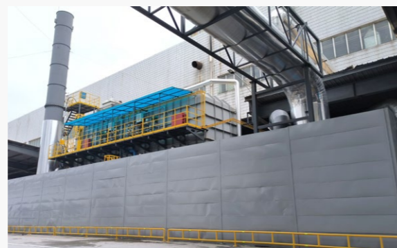
广州松下空调器有限公司废气收集处理系统
