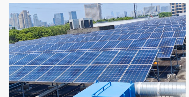
无锡松下冷机有限公司光伏发电系统
