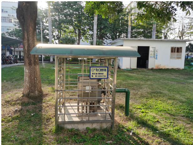
雨水排放口（应急阀门）
