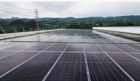
光伏发电系统
