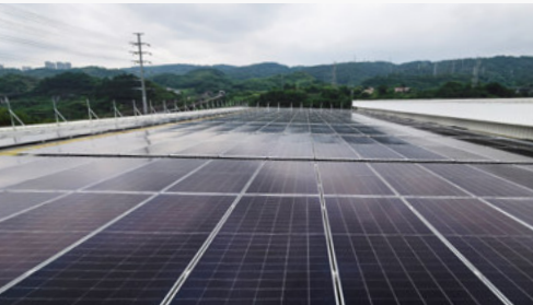
光伏发电系统
