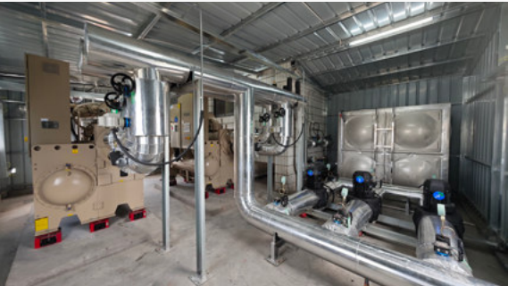
磁悬浮空调系统和组合空调箱
