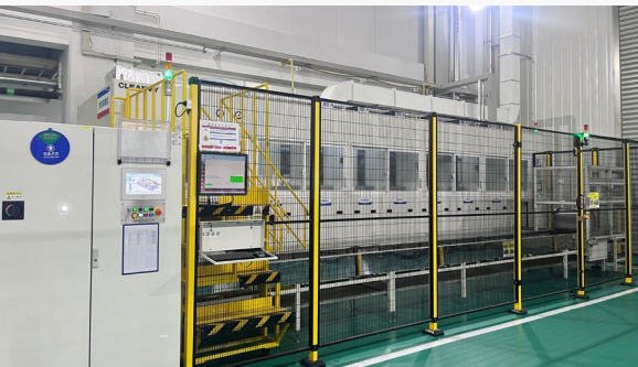
改造后的水剂型清洗设备
