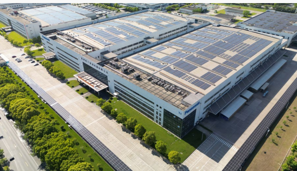
杭州松下家用电器有限公司光伏发电系统
