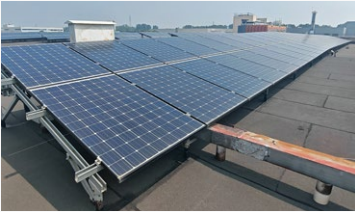
松下电气机器（北京）有限公司光伏系统
